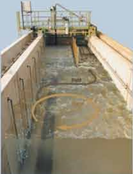
Sandfang: Sand und Fette werden abgeschieden.
