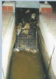
Siebrechen: Entfernt grobe Verunreinigungen
